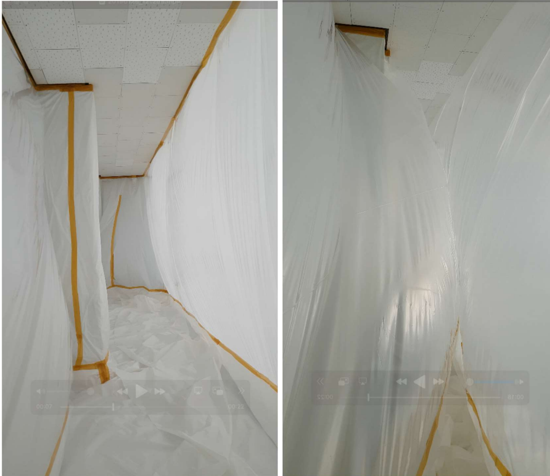
<사진, 석면철거현장에서 제대로 음압기가 작동해 음압이 걸린 상태. 바람을 빼내 압력이 내려가면서 보양비닐이 안쪽으로 부풀어 오른다. 석면철거과정에서 발생하는 석면먼지가 외부로 새나가지 않도록 하기 위함이다. 음압기에는 헤파필터를 장착해 석면먼지를 걸러야 한다.>
